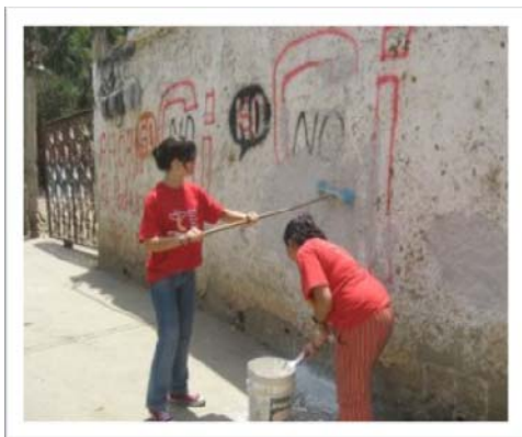
VISTA QUE PERMITE APRECIAR LA NECESIDAD DE LA ACTIVIDAD DE PINTADO EN EL MURO PERIMETRICO DE UN COLEGIO ESTATAL
